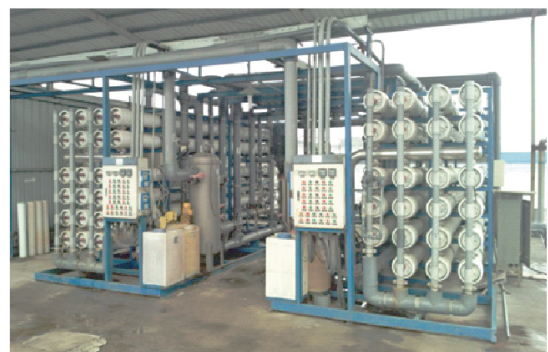
② 绍兴某公司2300T/D中水回用项目
